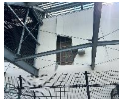
医療施設 被災状況
