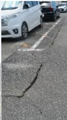
宇城警察署 駐車場の亀裂
