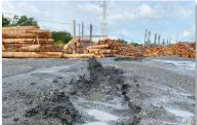
木材市場の土場の亀裂及び液状化（八代市）
