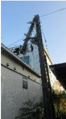
宇城警察署 電線引込柱の折損
