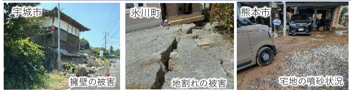
宅地の被害状況
