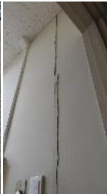
御船警察署 庁舎内の亀裂
