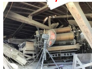
いぐさ製織作業場の倒壊→ （八代市）
