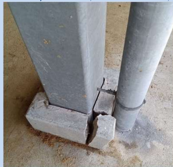
柱基礎の破損
