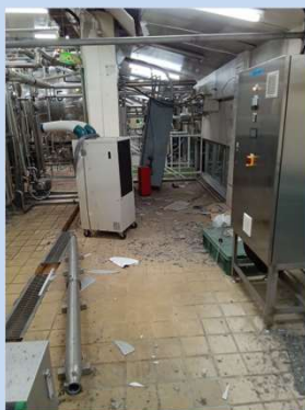
壁面・配管の破損
