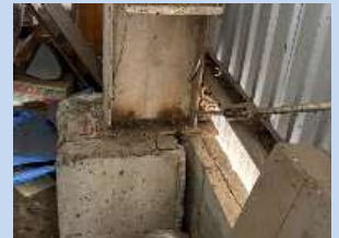
柱基礎の破損
