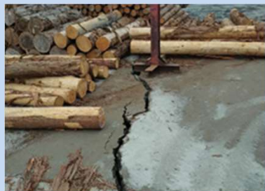
施設内での液状化
