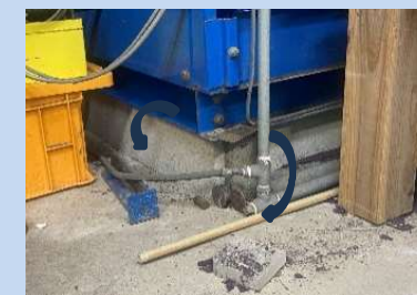
ノリ乾燥機の土台の破損
