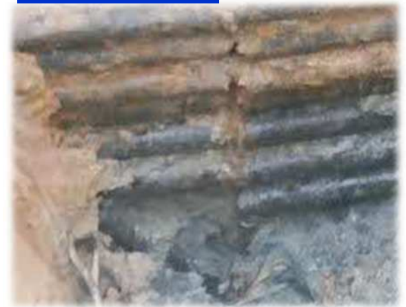
埋設管路損傷
