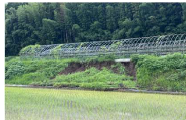
⑫農地の法面崩壊（熊本市）
