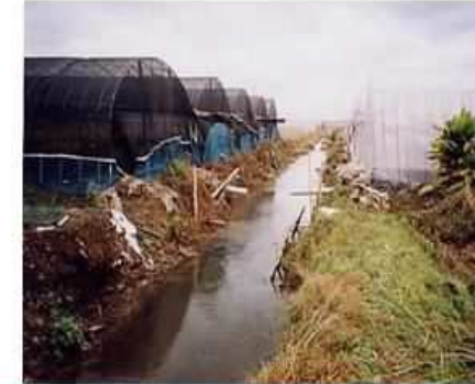
(事業実施前) 排水路の排水能力が低く、常に地下水位が高い状態で、収量・品質の低下が懸念される。
