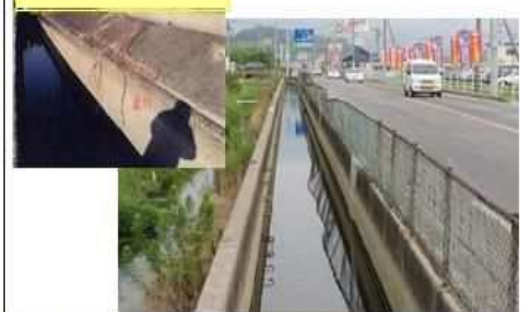
水路側壁のひび割れ
