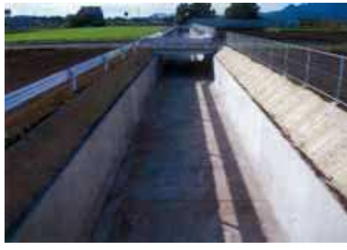
農地保全整備事業により整備された排水路
