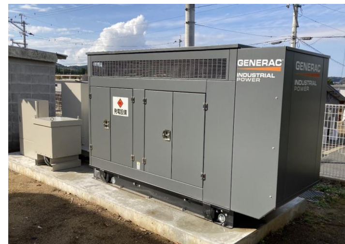
〈非常用自家発電設備の整備（宇城市）〉
