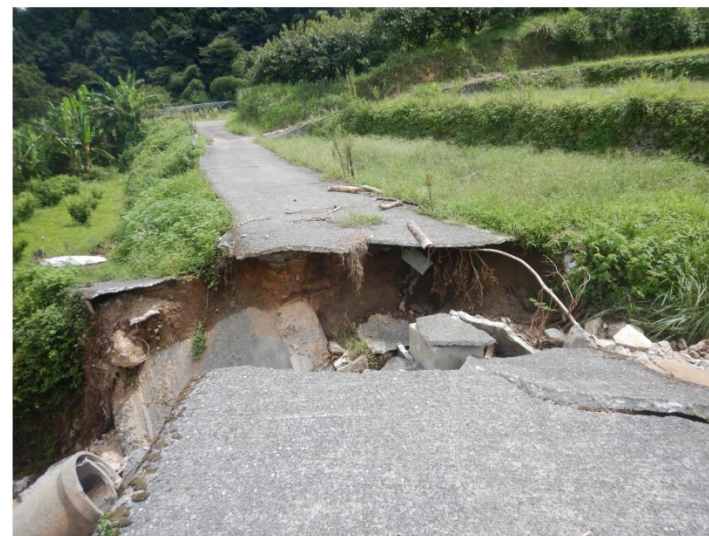
農道の崩壊（美里町）
