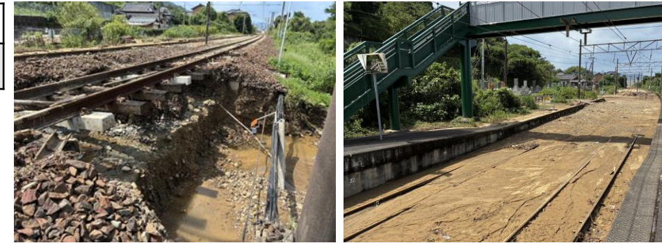
(R7.8.13肥後高田駅近くの状況)
