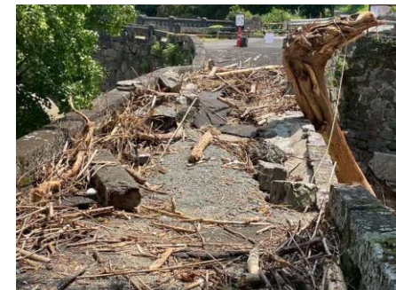
(二俣橋の被害状況)
