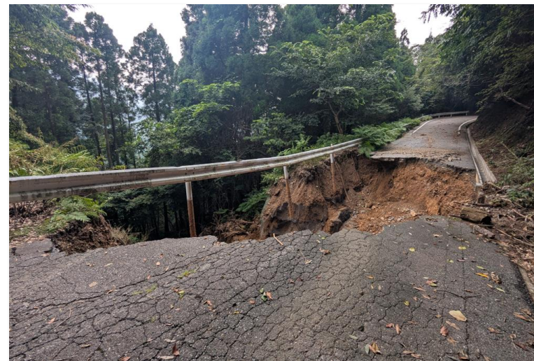
林道の崩壊（美里町）
