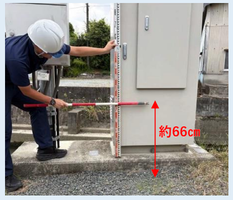
●沖糖地区真空式下水道施設（氷川町）
