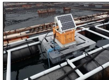
自動水質監視テレメーター
