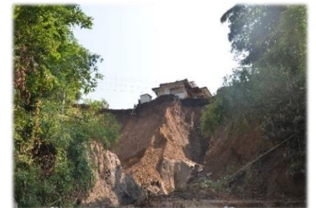
急傾斜崩壊被害 (美里町)
