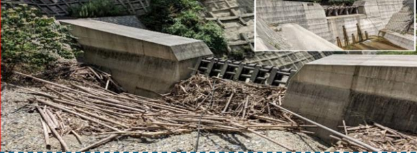
砂防堰堤（土石流発生後）
