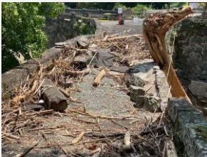
▲二俣橋の被害状況
