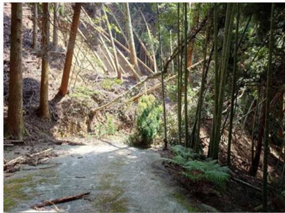
林道の法面崩壊(甲佐町)
