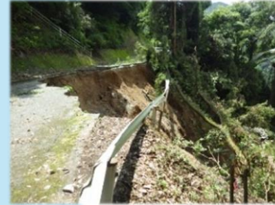
道路崩壊 (甲佐町)
