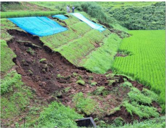
農地の法面崩壊(菊池市)
