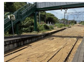
(肥薩おれんじ鉄道) 肥後高田駅近くの様子 (8/12 12時頃)
