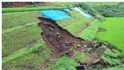
農地法面崩壊 【菊池市木庭町】
