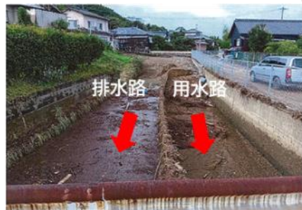
土砂堆積(用・排水路) 【八代市敷川内町】
