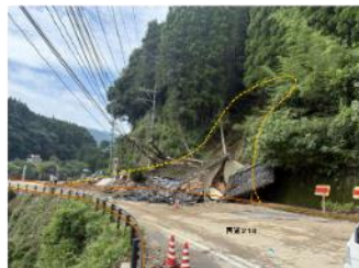
山腹崩壊 【美里町豊福肉伏】
