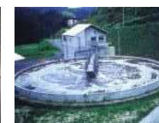
畜産環境対策施設
