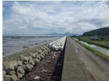
消波ブロック整備状況
