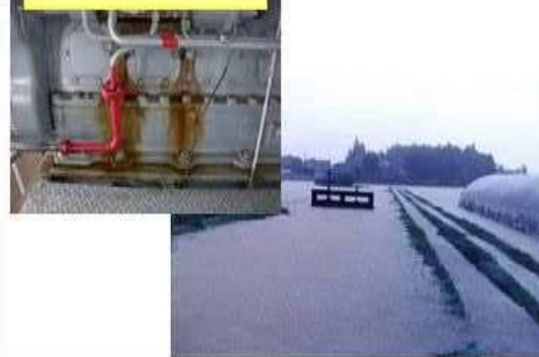
機器からのオイル漏れ
