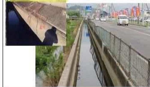
水路側壁のひび割れ
