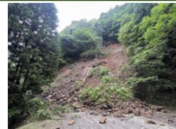
⑪林道の法面崩壊（球磨村）
