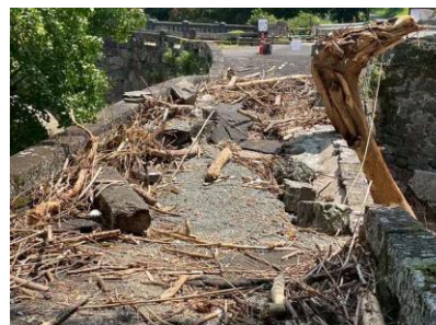
《二俣橋の被災状況》
