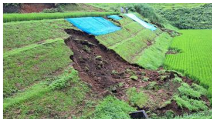
農地法面崩壊 【菊池市木庭町】
