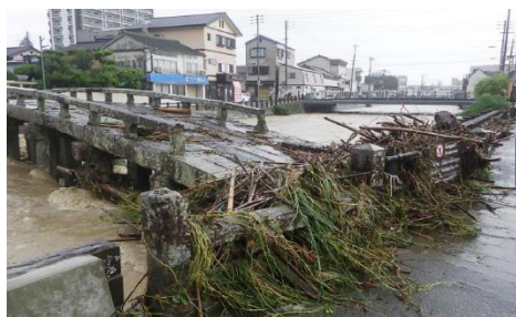
《祇園橋被災直後の状況》
