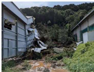
土砂流入による畜舎の破損（美里町）
