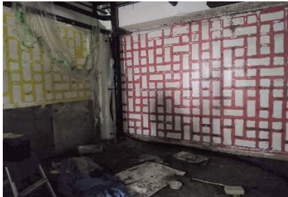
被災店舗（地下）（熊本市）
