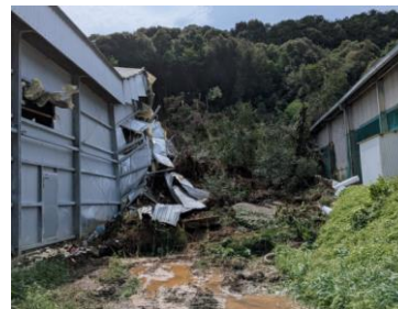
土砂流入による畜舎の破損（美里町）
