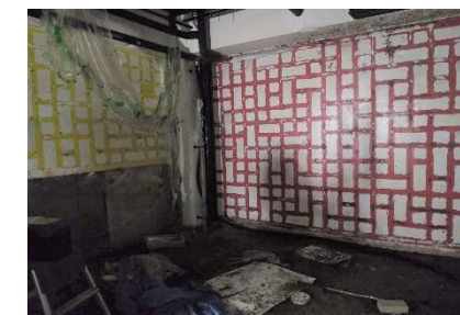
被災店舗（地下）（熊本市）
