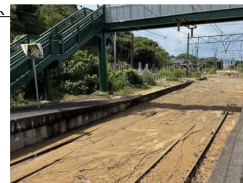
(肥薩おれんじ鉄道) 肥後高田駅近くの様子 (8/11 14時頃)
