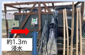
ハウス内暖房機の浸水
