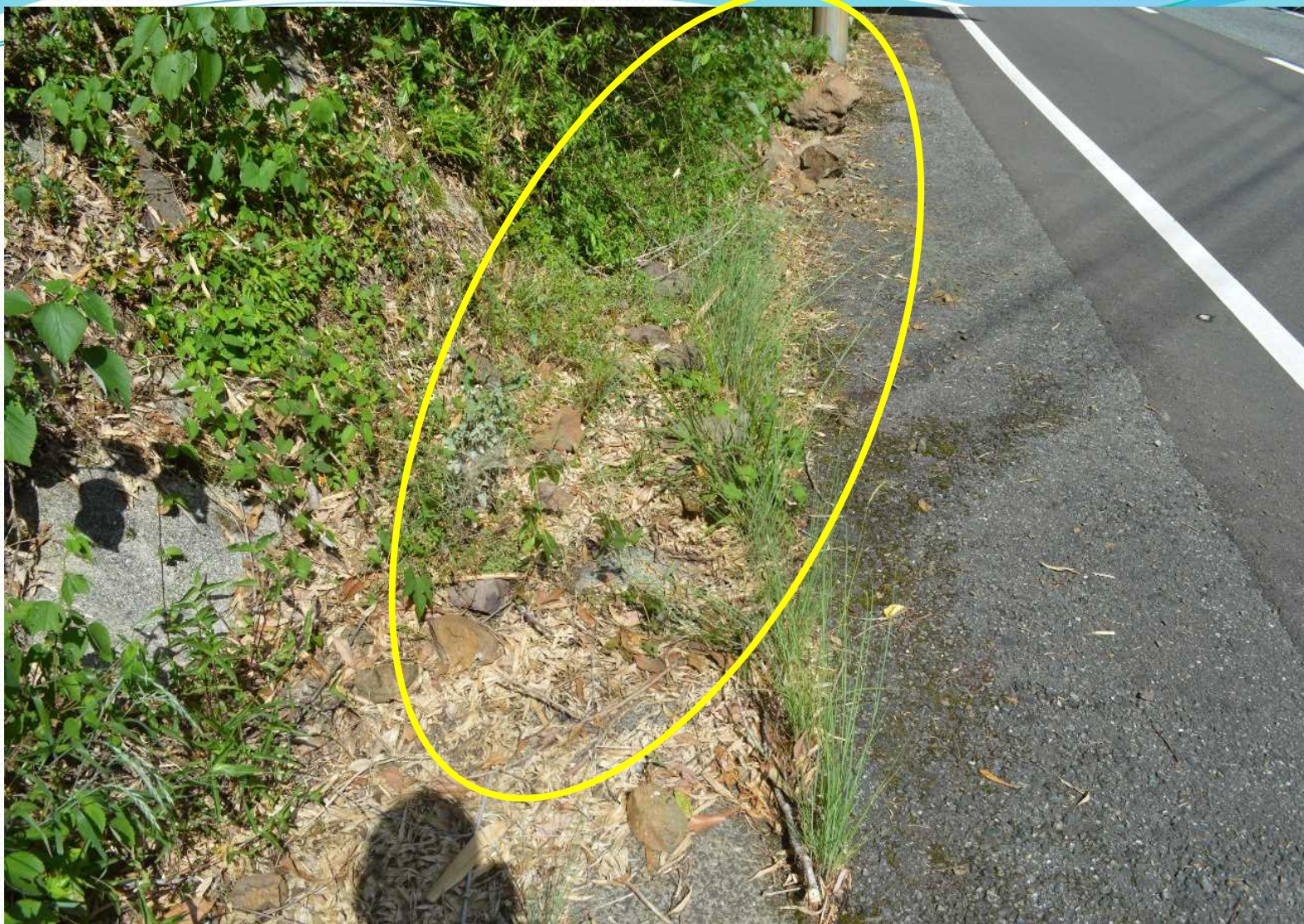
法尻に落下している石の状況
