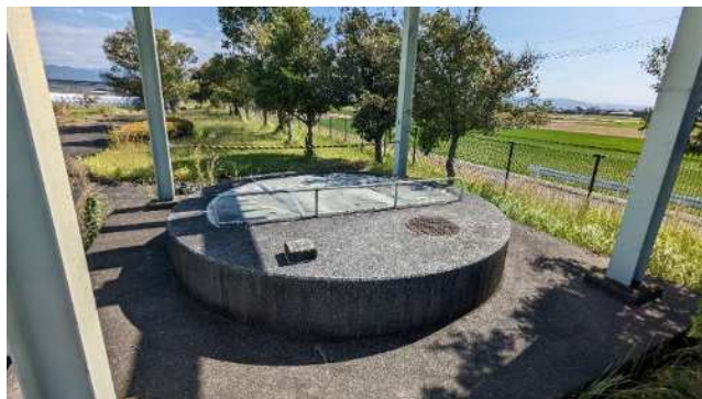
マンホールポンプピット
