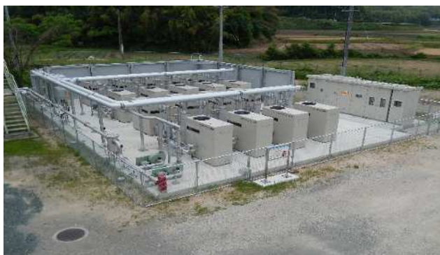
消化ガス発電設備
