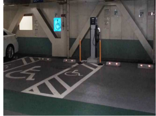
障がい者用駐車場と普通充電器
