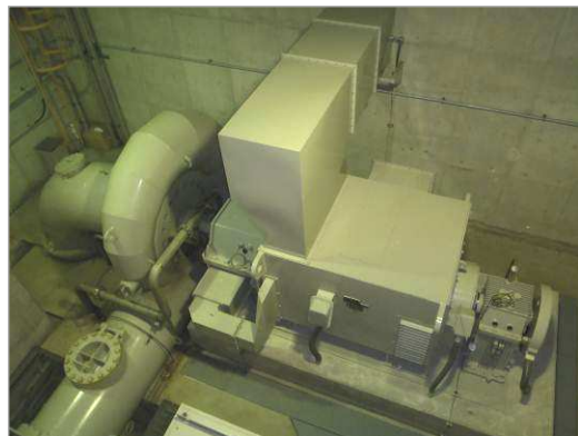
第三発電所発電機
