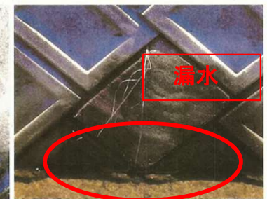
水路3 ここはもとも壊れていたブロックがどうなったかわからない
