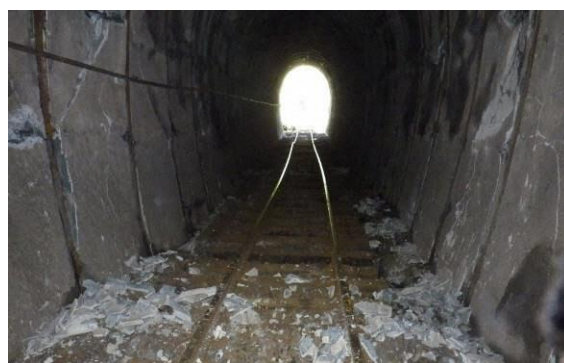
写真 犀角山トンネル内の亀裂
