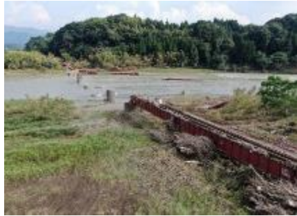
流失した球磨川第4橋梁
