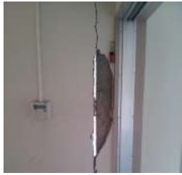
【松橋東支援学校】 棟の継ぎ目に入った亀裂
