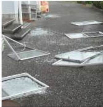
【松橋西支援学校】 落下した体育館の窓
