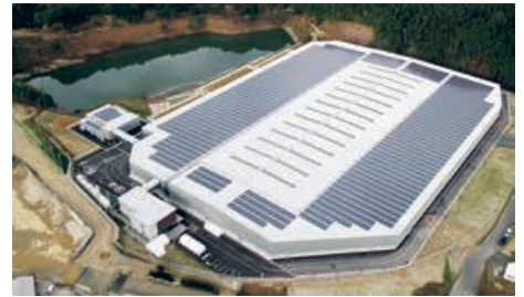
公共関与最終処分場「エコあくもと」 屋根の太陽光発電【南関町】
