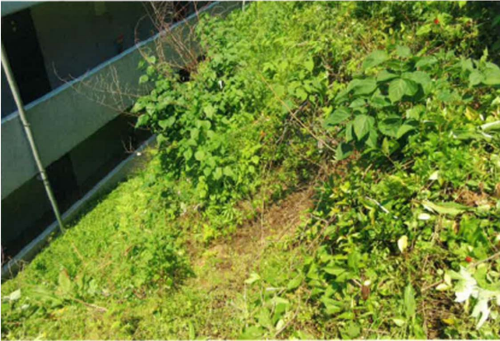
がけ側 一部くずれ
