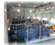
農業水利施設（排水機場）
