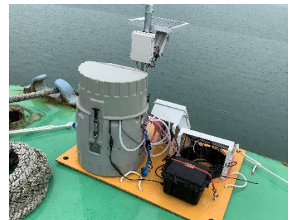
図1 テレメータシステムの設置状況
