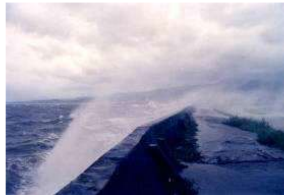
越波による被害 2 (出水市)
