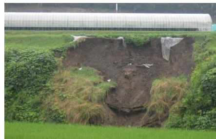
② 農地の法面崩壊（西原村）
