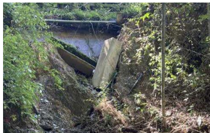
③ 水路の損壊（錦町）
