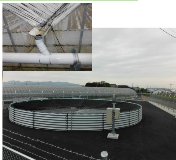
宇土割地区に設置された雨水貯水槽 (ハウスの屋根に降った雨を集水し施設園芸の灌水に利用)
