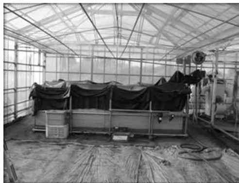
写真1 ハウス内に設置した貯水槽
