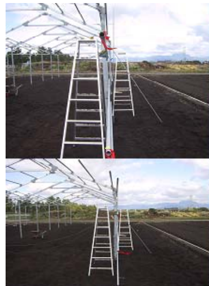
写真4 ハウス軒の変位状況
