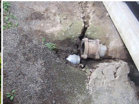
(排水管の損傷)
