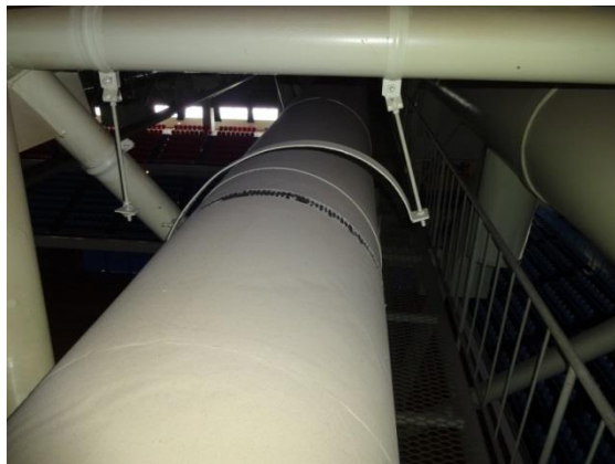
(大体育室天井吊り金具の破損)
