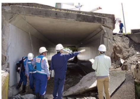
TEC-FORCEによる益城町道路被災状況調査 ※国土交通省HPより (平成28年熊本地震におけるTEC-FORCEによる活動状況)
