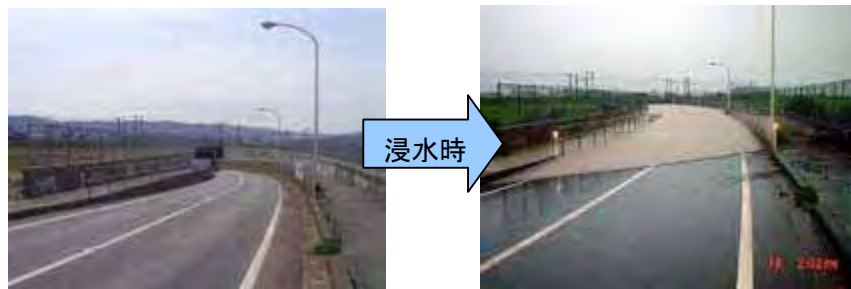
図 3.4.4 アンダーパスの浸水状況（出典：洪水ハザードマップ作成の手引き）
