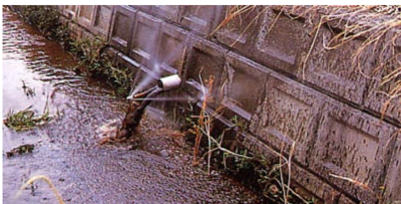
図 3 洗管ノズルが暗渠末端から貫通した状況
