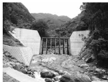
生物多様性に配慮した事業 (透過型砂防堰堤)
