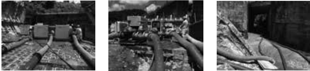
排水ポンプによる強制排水
