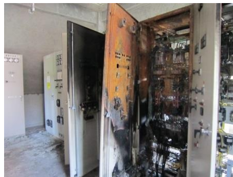
上東排水機場（電気設備）の火災（上天草市）
