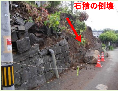
空石積造擁壁の倒壊
