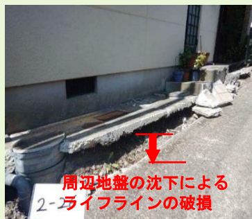
周辺地盤の沈下によるライフラインの破損
