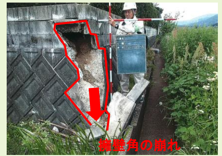
出隅部の倒壊
