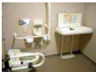
ベビーシートと温水洗 浄機能付便座まわり 車いす使用者等が便座 に座ったまま手洗いが できる。
