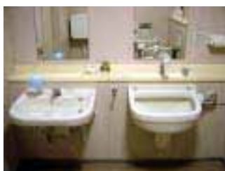
洗面台横に設けられた オストメイト対応汚物 流し。 温水シャワー機能付で 衣類が汚れても洗うこ とができる。
