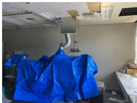
水漏れによる分析機器の損傷
