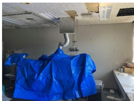
水漏れによる分析機器の損傷
