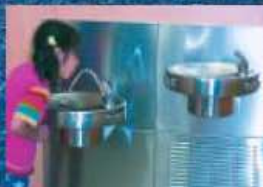
だれもが使いやすいように設置 された高さの異なる水飲み器 (県庁舎)
